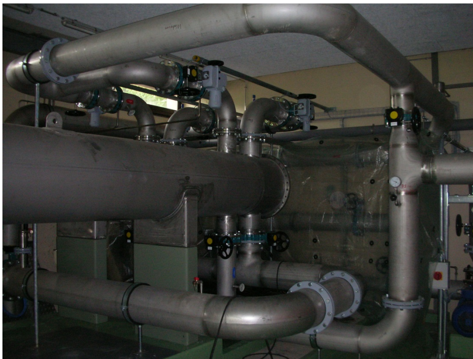
Bild 1: Wärmetauscher in der Förderstation der ARA
